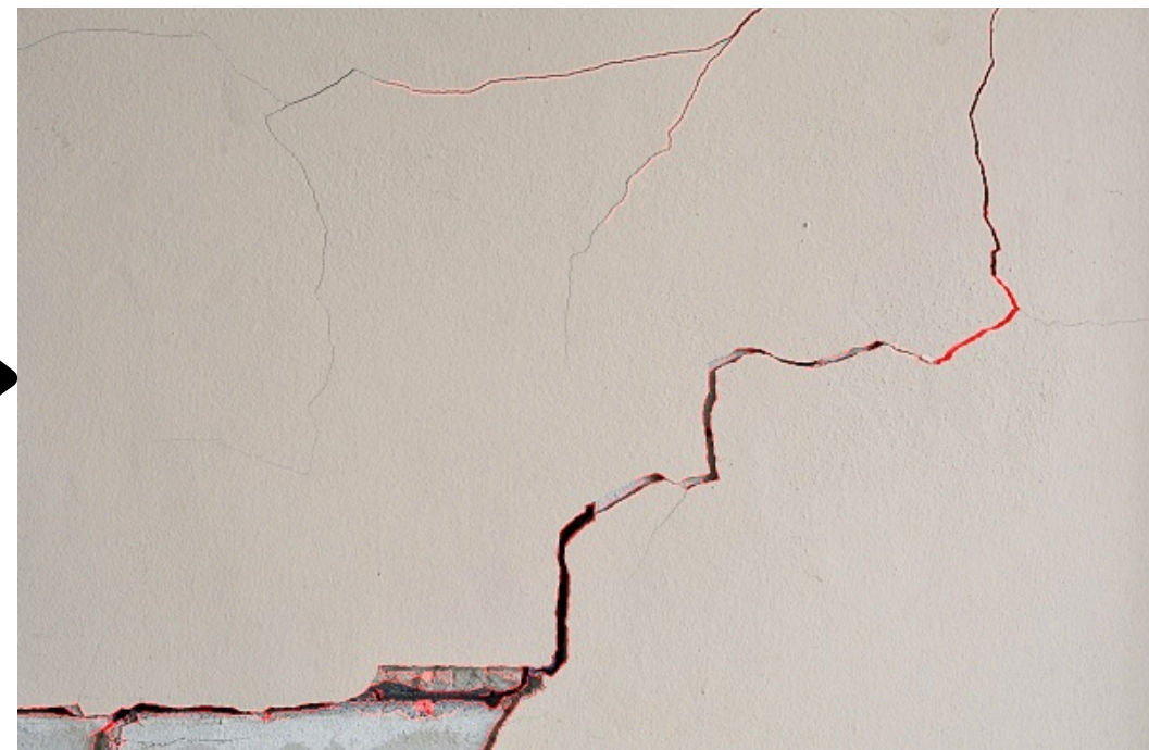
系統自動檢測裂縫
